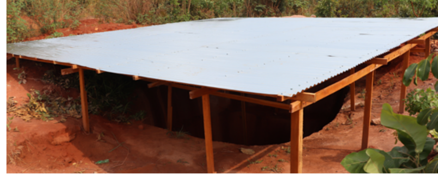
L'un des cinq puits couverts lors de la phase pilote du projet de couverture. Les cinq puits ont été recouverts de tôles galvanisées, boulonnées à des cadres en bois renforcés par du béton à la base, afin de stabiliser les points d'entrée du site de la mine artisanale de Kamilombe.
