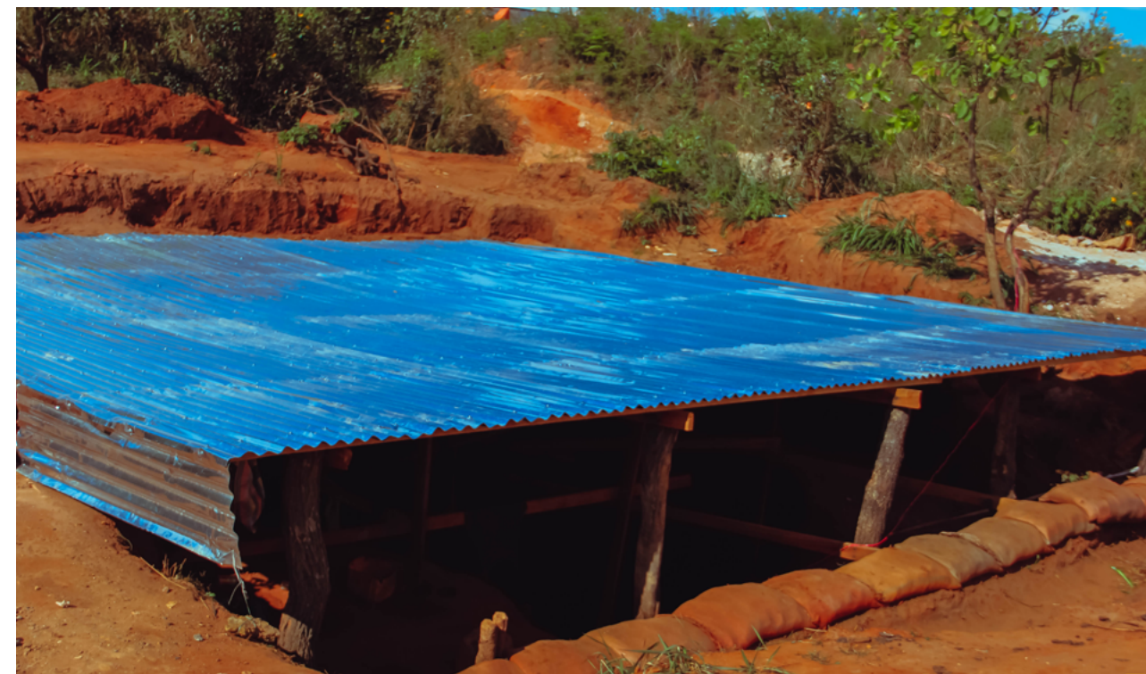
Un puit récemment couvert avec les tôles galvanisées – une alternative durable aux bâches généralement utilisées – afin de prévenir les accidents tels que les chutes de pierres et d'autres risques, tels que les inondations en cas de pluie.
